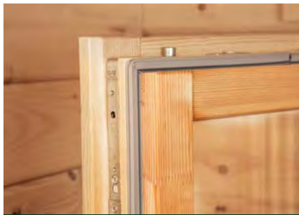
Fenster- und Türdichtung
